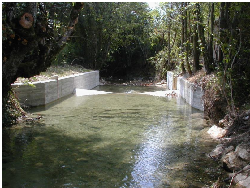
Figura 2 Estación de aforo SA05-Manantial Zarpia, con vertedero Crump, instalada aguas abajo del manantial.
