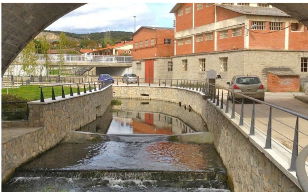
Fig. 2.1.- Estación de aforo tipo. Vertedero Crump modificado (SA04-Manantial Nanclares de la Oca)
