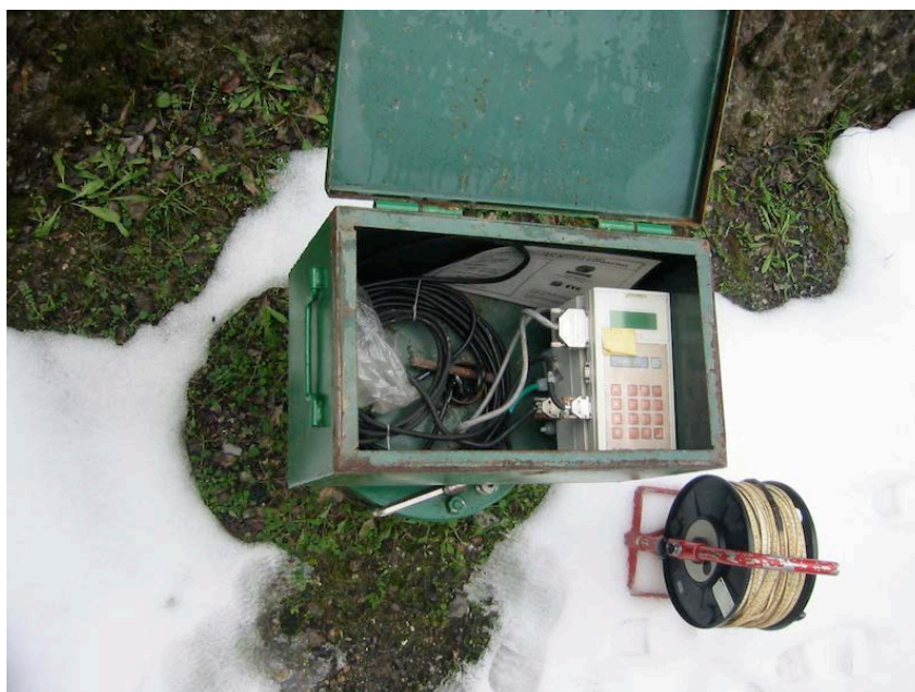
Fig. 2.2.- Estación de control piezométrico SP07-Sondeo MAÑARIA-2.
