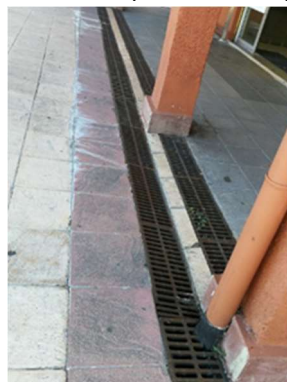
Ilustración 22: Canaleta drenaje exterior de acceso a vestíbulo
