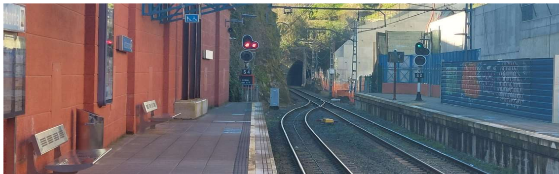
Ilustración 6: Pérdida progresiva de anchura en andén sentido Hendaia lado Donostia
