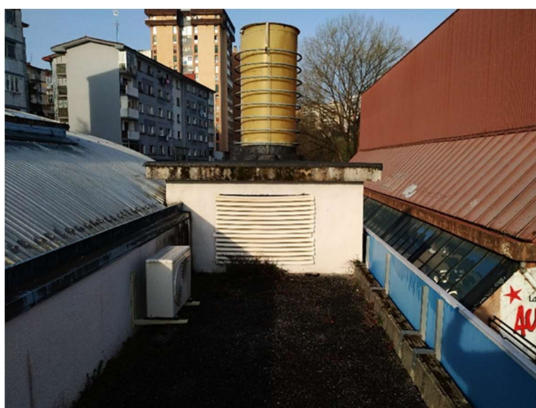
Ilustración 19 : Patologías en cubierta vestíbulo de estación
