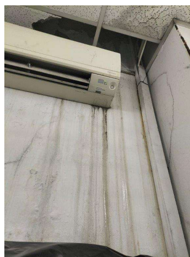
Ilustración 13 Filtraciones en cuarto de comunicaciones
