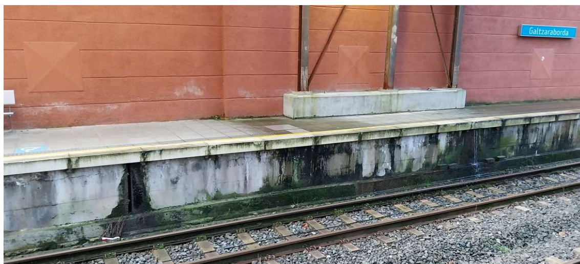
Ilustración 7: Filtraciones de agua del talud a través del andén
