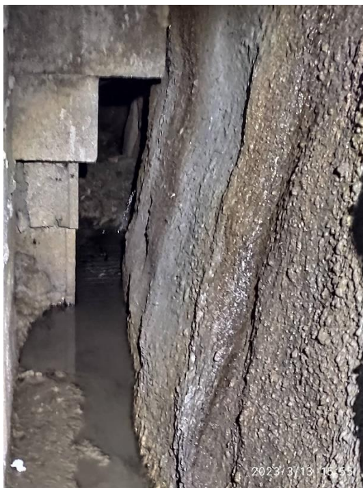
Ilustración 8: detalle del talud y de agua acumulada en el pie, junto al muro de bloque evidenciando problemas de drenaje.
