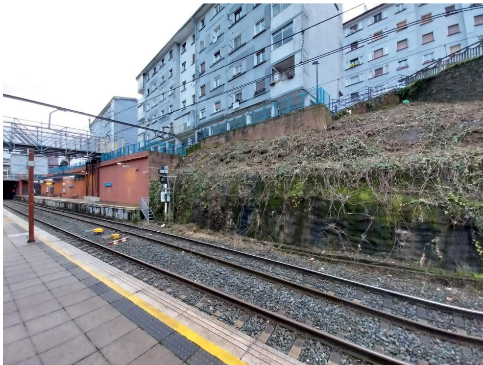
Ilustración 10: Vista del talud bajo la calle Apeadero. Ubicación del futuro acceso a las obras (a ejecutar por el tramo Altza-Galtzaraborda)
