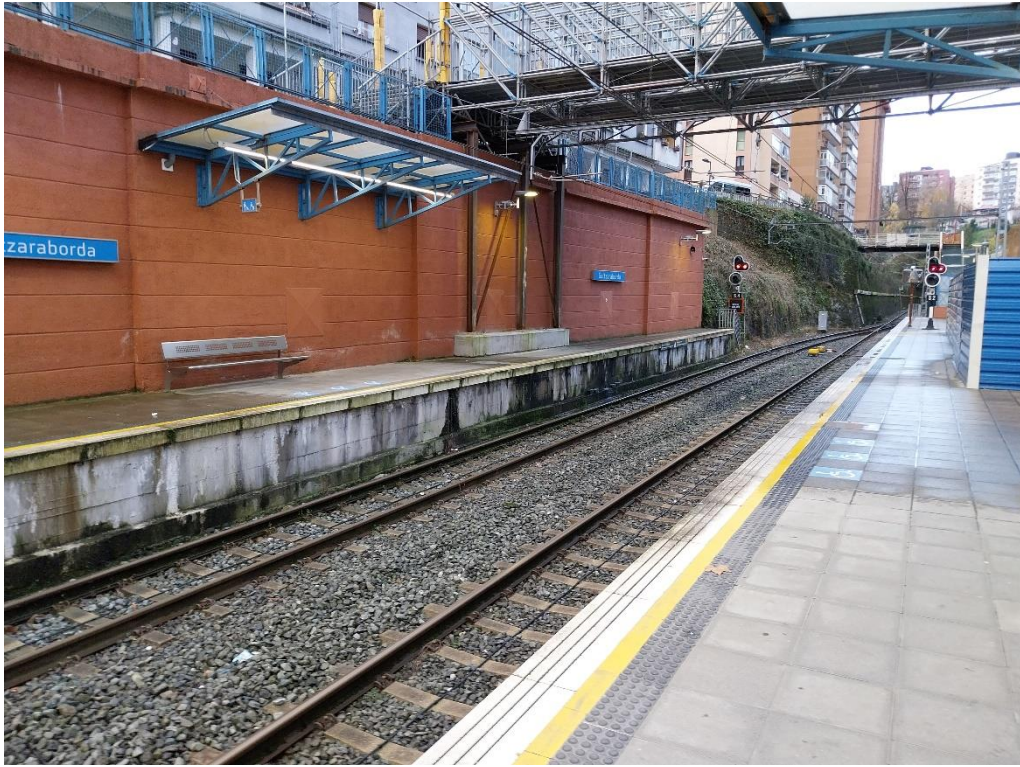
Ilustración 29: Vista del andén sur desde el Norte. Se observa la pasarela provisional y la altura excesiva de las marquesinas
