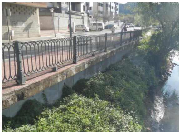
Figura 63. P Zona a disponer muro en MD aguas arriba del puente de la c/Zubialde
