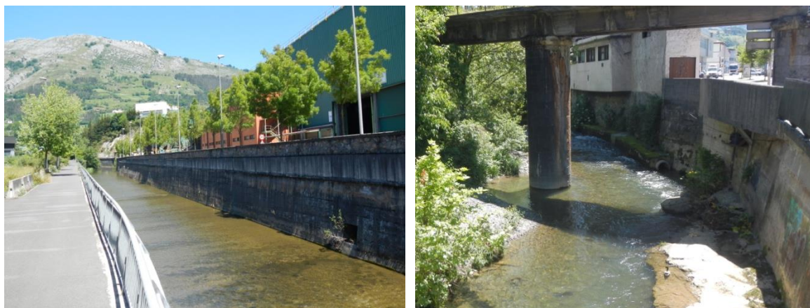
Figura 37. Izquierda: Tramo encauzado a naturalizar. Derecha: Estado del río Ibaieder aguas abajo del tramo encauzado donde la fijación del lecho está rota.
