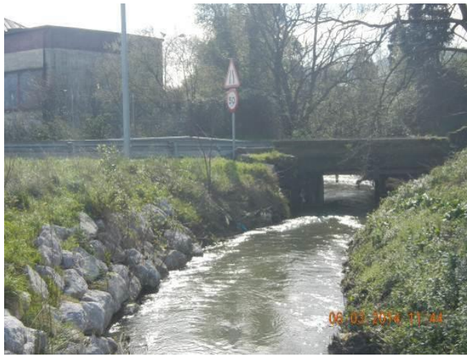
Figura 93. Puente de la c/Bº de Trápaga a sustituir por la obstrucción que causa
