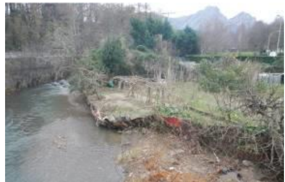
Foto 6. Margen izquierda aguas arriba del puente con evidencias de erosión.
