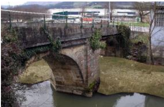
Foto 5. Puente de Astola, ojo de la margen izquierda colmatado.
