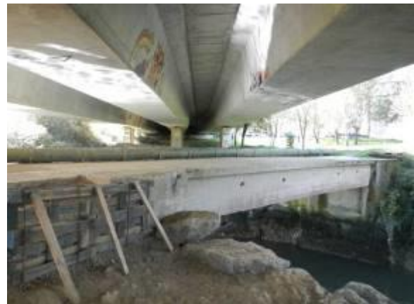
Foto 29 Zona de cierre del muro en MI bajo el paso de la BI-635.
