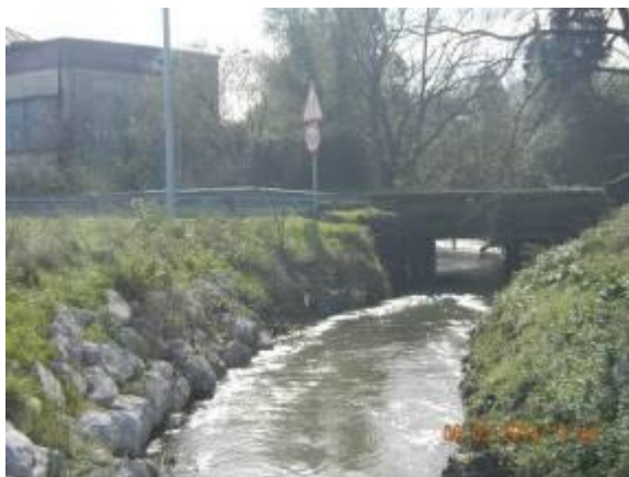
Foto 60 Puente de la c/Bº de Trápaga a sustituir por la obstrucción que causa.
