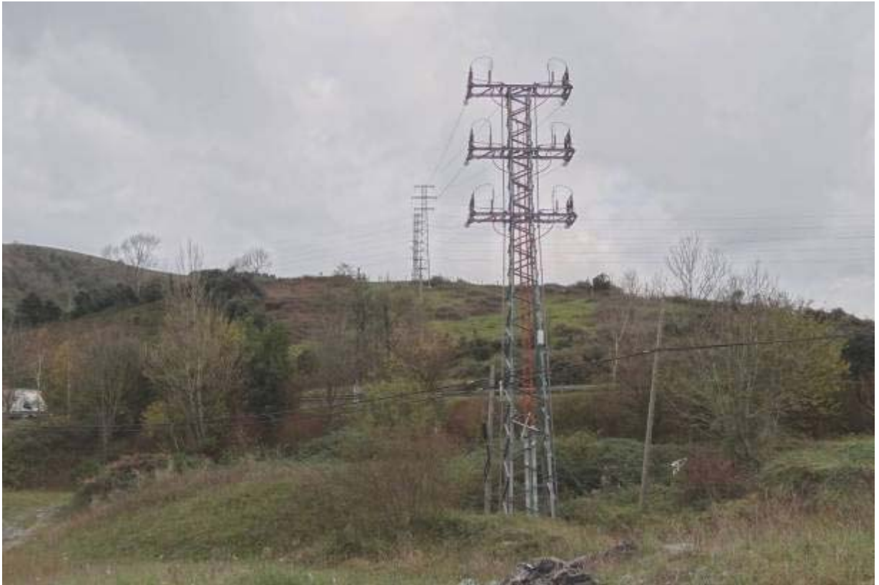
Figura 123: Impacto paisajístico de las torres de conducción eléctrica.
