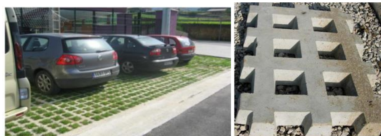
Figura 6: Parking con pavimento permeable de hormigón armado. Fuente: Paviprint
