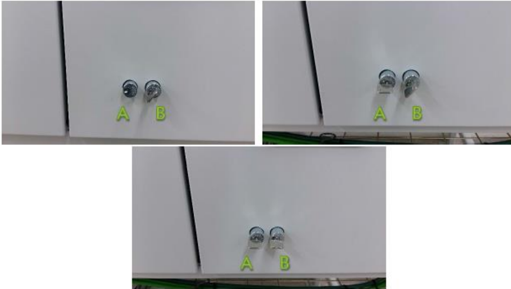
Figura 8. Señalización para el acceso al interior del armario con seguridad
