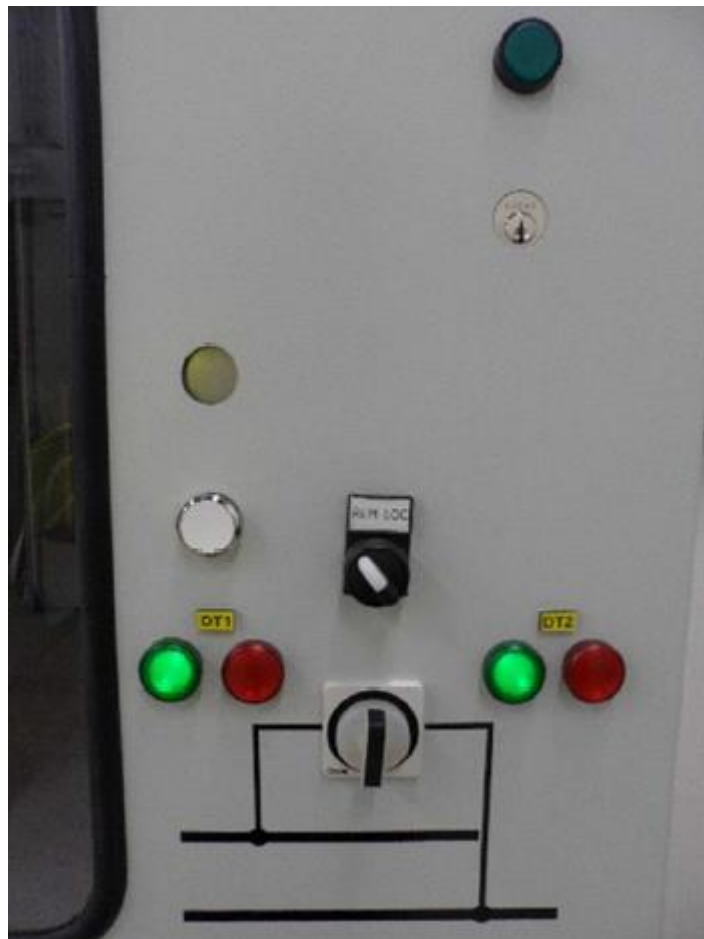
Fotografía 1. Mando local en celda ruptor de estación de Altza.
