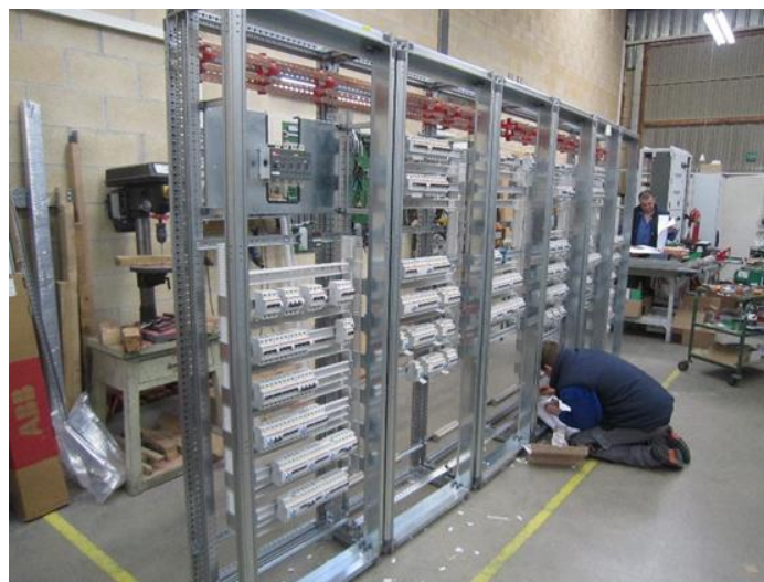
Figura 1. Cuadros eléctricos montados y probados en fábrica
