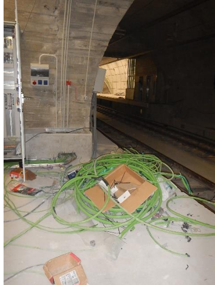
Figura 3. Residuos generados en obra en el montaje de equipos eléctricos en una galería de ventilación
