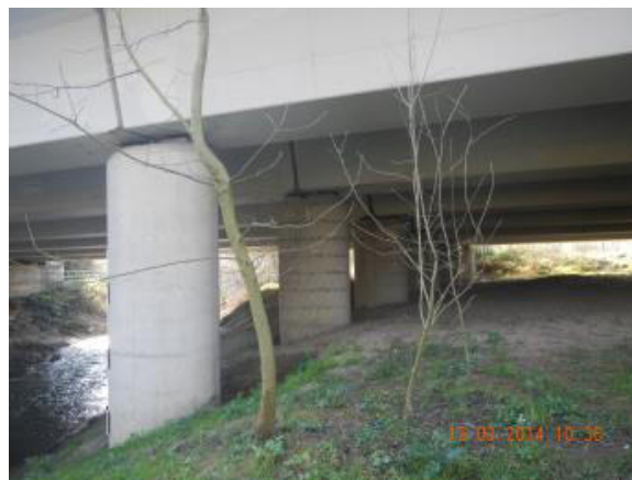
Figura 33.- Vista hacia a/arriba de las pilas en MI del paso de BI-631
