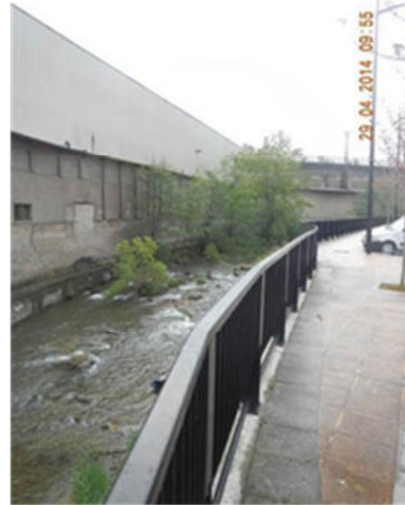
Figura 56.- Barandilla en MI que se ha de sustituir por muro
