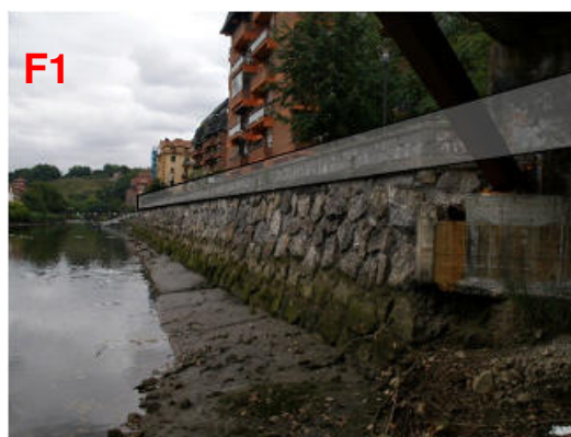
Figura 18.- Margen izquierda aguas arriba del hoy sustituido puente de ETS en la que se plantea un lezón.
