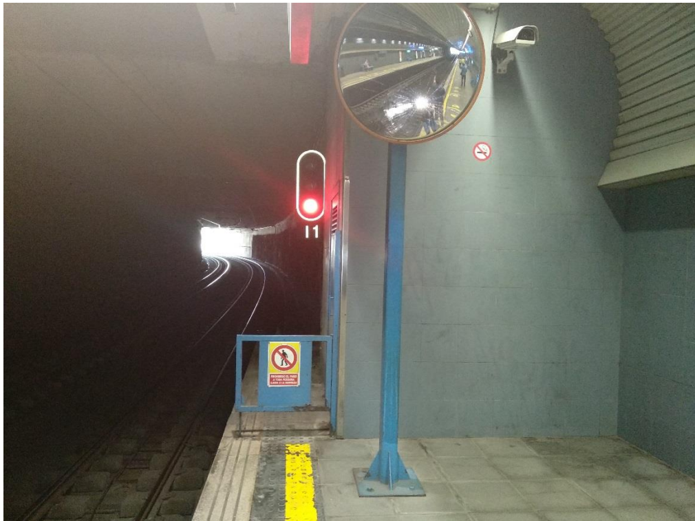
Fotografía 25. Señal I1 andén Hendaia
