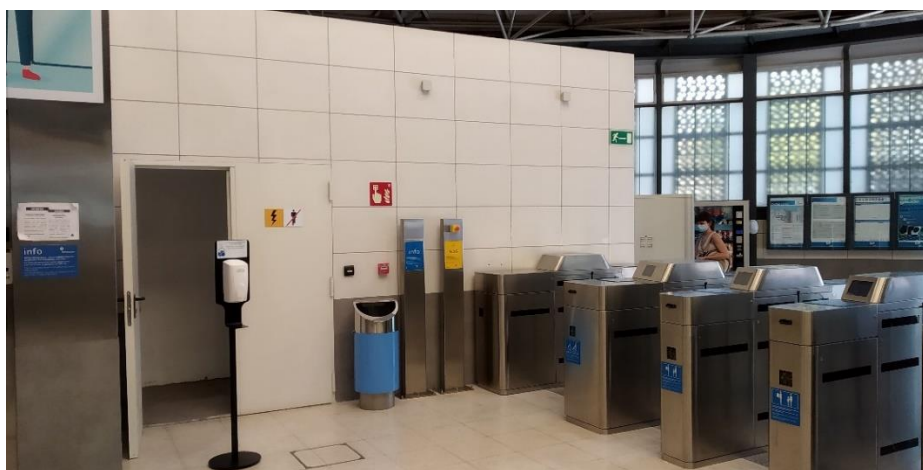
Fotografía 5. Acceso a cuartos técnicos
