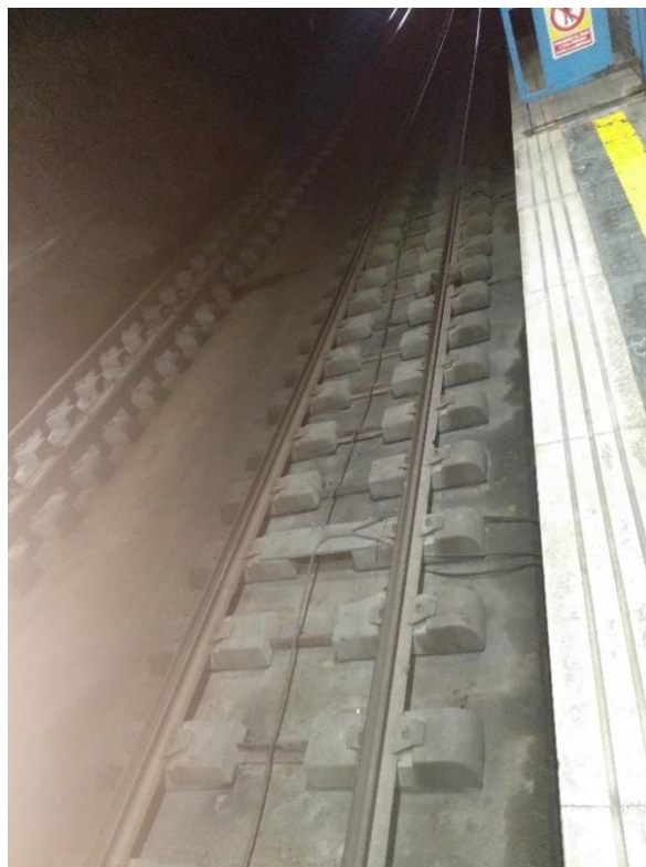
Fotografía 27. Equipos de señalización en vía. Sentido Hendaia II
