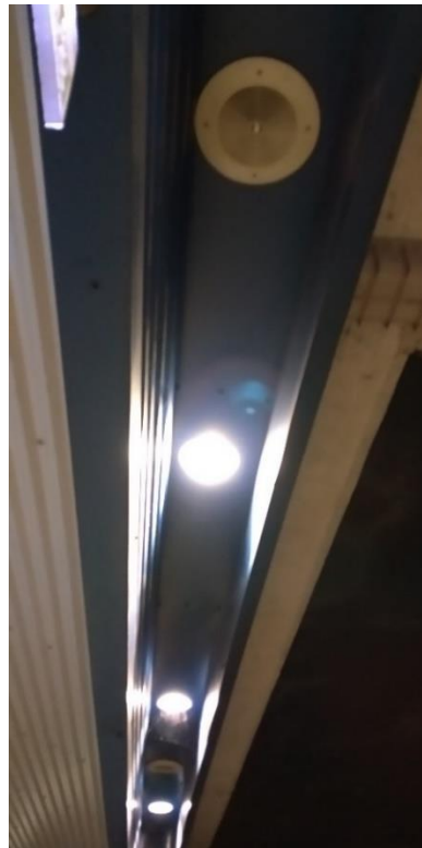
Fotografía 23. Altavoces de megafonía empotrados en techo de andén
