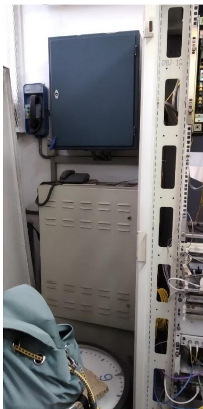
Fotografía 10. Armarios del Sistema TREN-TIERRA
