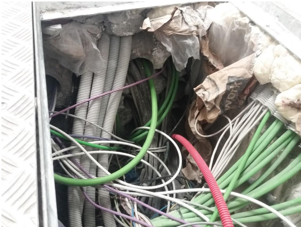
Fotografía 20. Arqueta comunicación con cuarto señalización y comunicaciones
