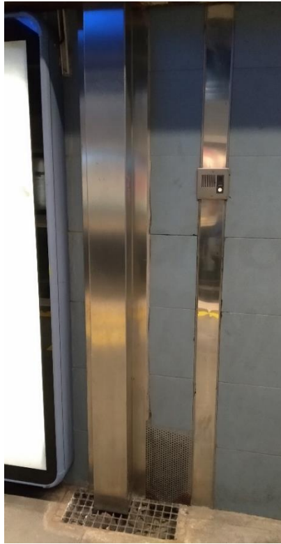
Fotografía 24. Interfono y canalización a bajo andén
