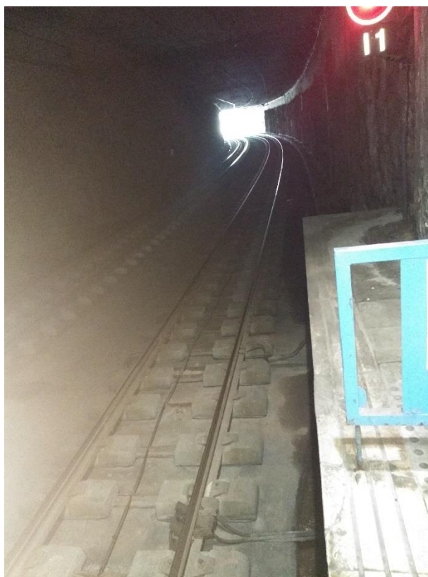
Fotografía 28. Equipos de señalización en vía. Sentido Hendaia III
