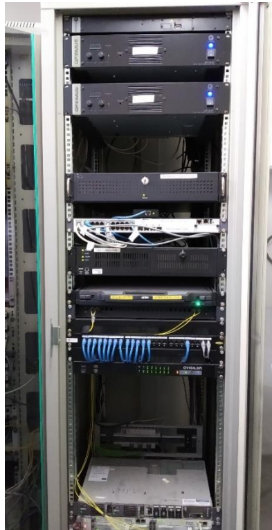
Fotografía 6. Rack Nodo MPLS, Teleindicadores, Megafonía y CCTV
