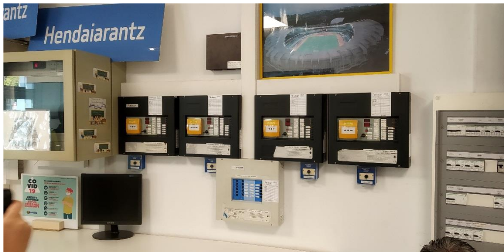
Fotografía 19. Centrales de detección y extinción de incendios
