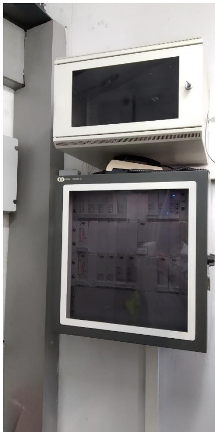
Fotografía 15. Armarios de selectivo fuera de servicio
