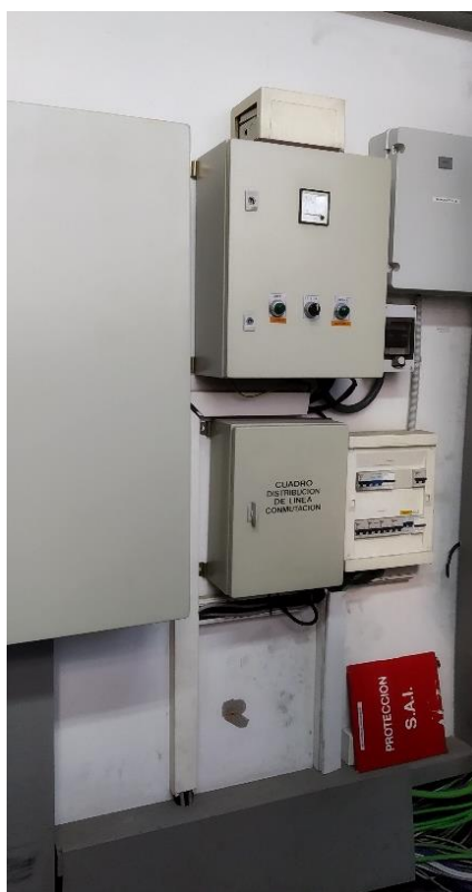
Fotografía 11. Cuadros IF: conmut. Automática Red 2,2 kV, cuadro general, cuadro SAI
