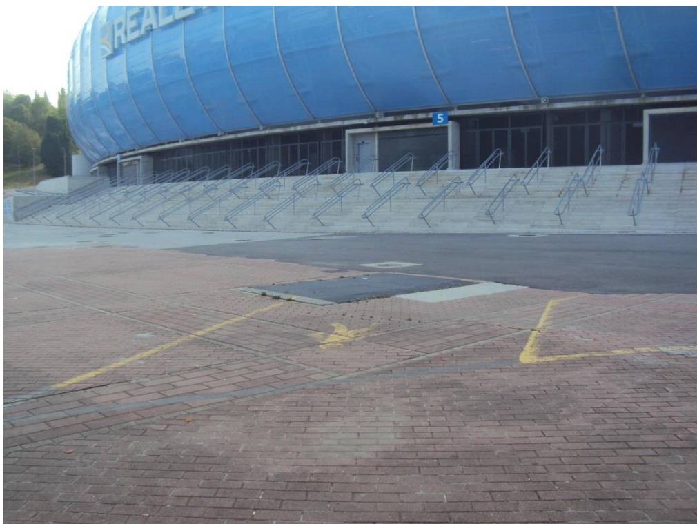
Fotografía 2. Rejilla ventilación de emergencia
