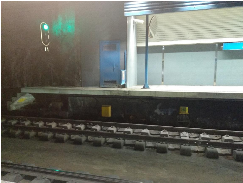
Fotografía 26. Equipos de señalización en vía. Sentido Hendaia I
