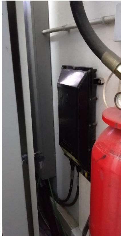
Fotografía 8. Caja de segregación de F.O. troncal
