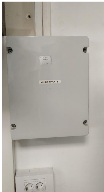
Fotografía 17. CPU Control de Accesos
