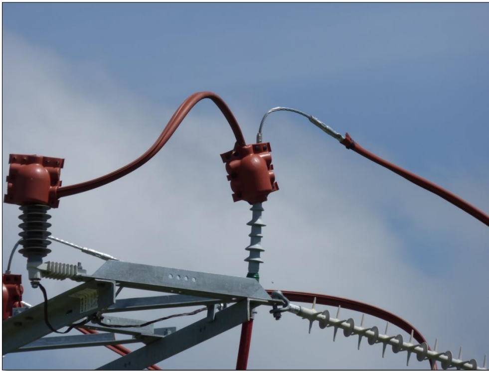
Figura 3. La mayor parte de los materiales aislantes anti-electrocución son perecederos y para ser eficaces requieren, por un lado, una correcta aplicación y, por otro, un mantenimiento que es responsabilidad de las empresas eléctricas propietarias. V.g. corrección mal ejecutada en el apoyo n° 9001 (Bi-78043), de la Línea 13.2 kV de Carranza-Arcentalles.
