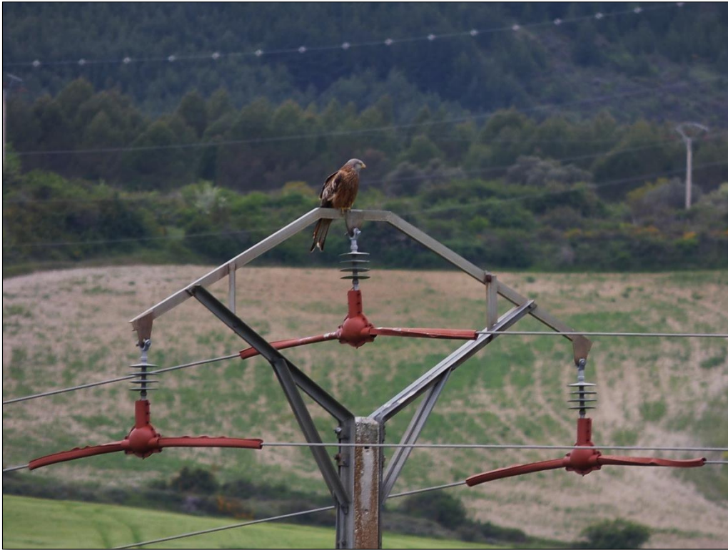
Figura 4. La aplicación del Real Decreto 1432/2008 y una buena ejecución de las medidas previstas en el Manual Técnico 2.24.80 de Iberdrola (I-DE) aseguran la inocuidad de las LAAT para la mayoría de las aves.
