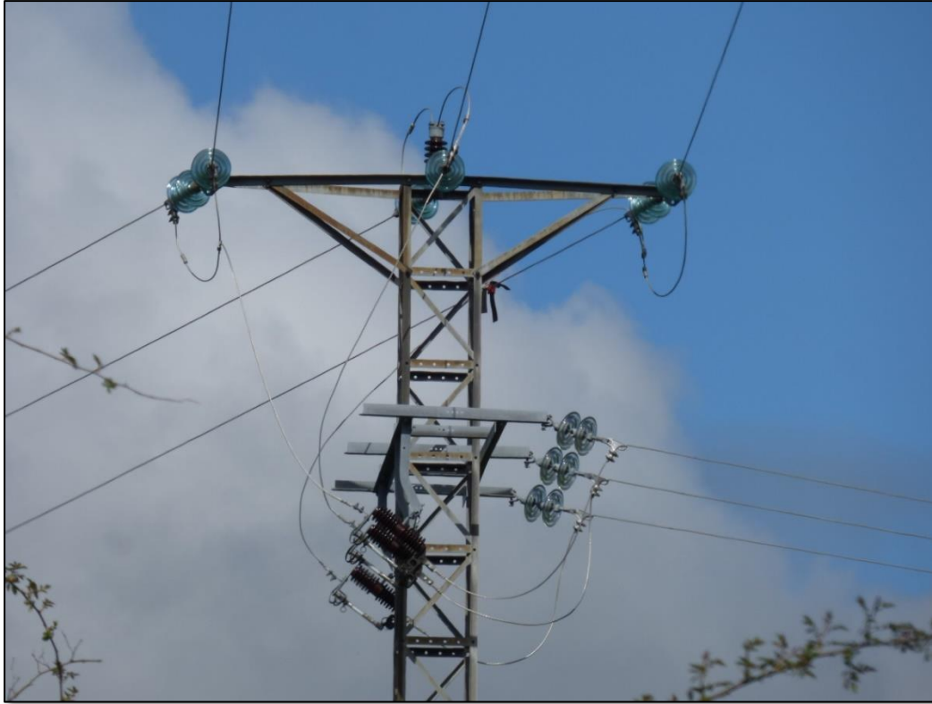
Figura 38. Apoyo de entronque y maniobra nº 111 (Bu-2036) de la Línea (13.2 kV) de Treviño que se mantiene sin corregir, con el puente flojo central dominante, cadenas de amarre de tan solo 2 aisladores y los puentes flojos sin aislar.
