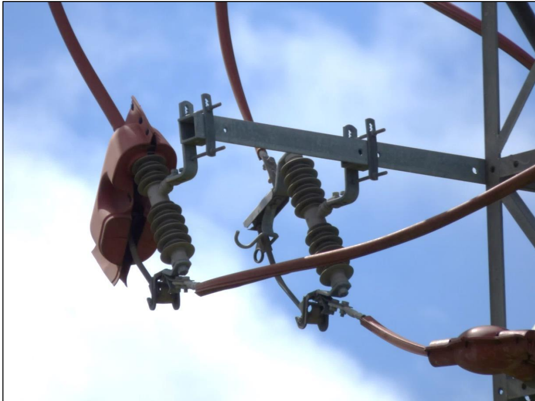
Figura 29. Apoyo de entronque y maniobra nº 92 (Vi-41749) de la Línea 13.2 kV de Gaceo en el que se aprecia que el preformado que protegía del seccionador de la fase central se ha caído.
