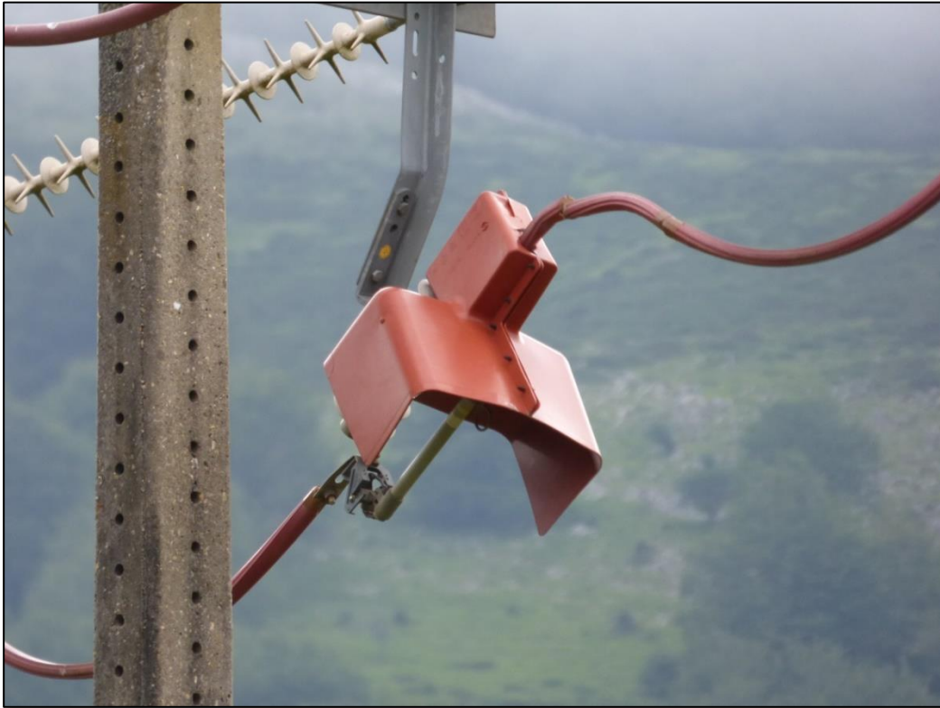
Figura 22. Detalle de los preformados anti-electrocución utilizados para proteger los fusibles-seccionadores de expulsión en los apoyos de maniobra existentes en la Línea de Oñati-Alustiza.
