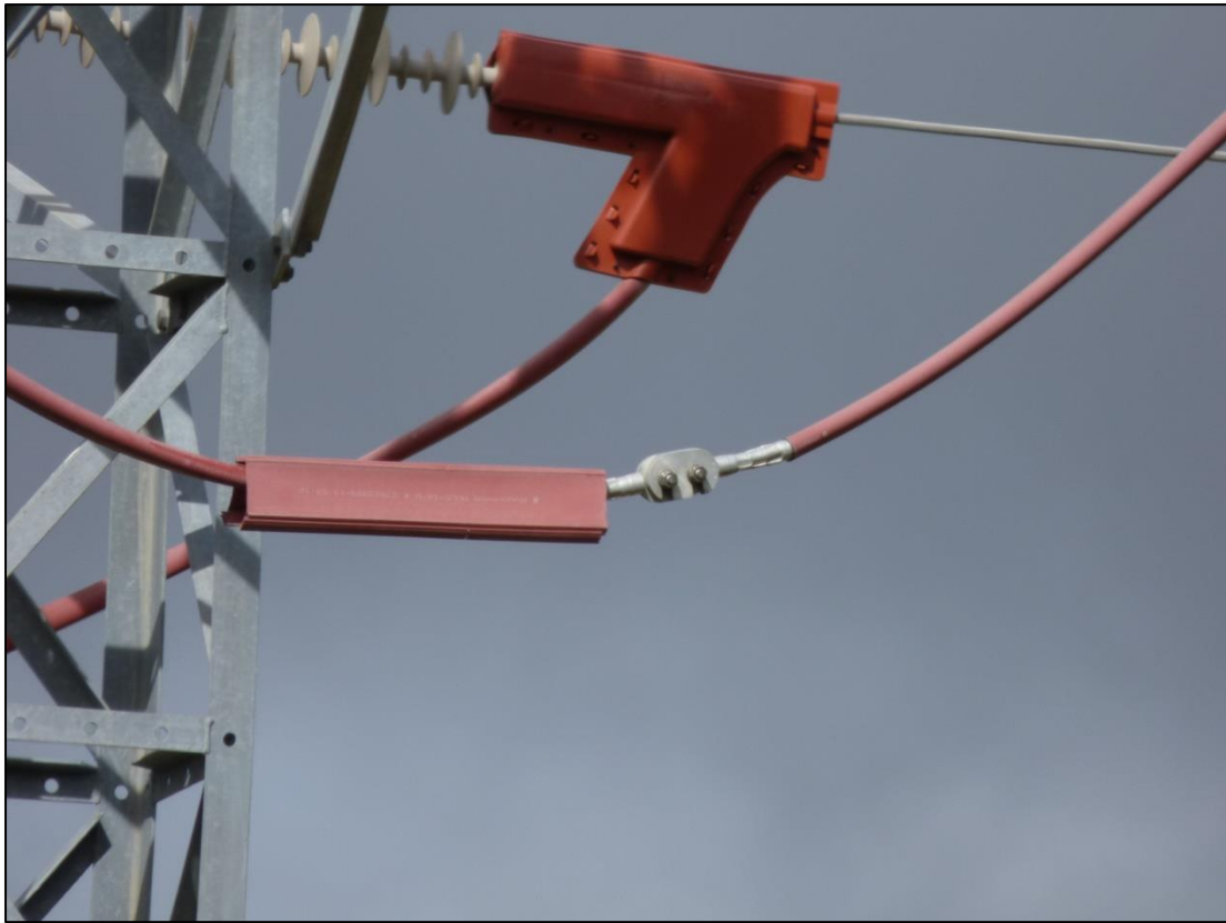
Figura 36. En algunos apoyos de la Línea Haro-Miranda los empalmes existentes en los puentes flojos se han protegido con cubiertas de silicona en lugar de emplear cubre-conectores específicos. Algunas de estas cubiertas, como las del apoyo nº 17, se han desplazado dejando al descubierto los empalmes.
