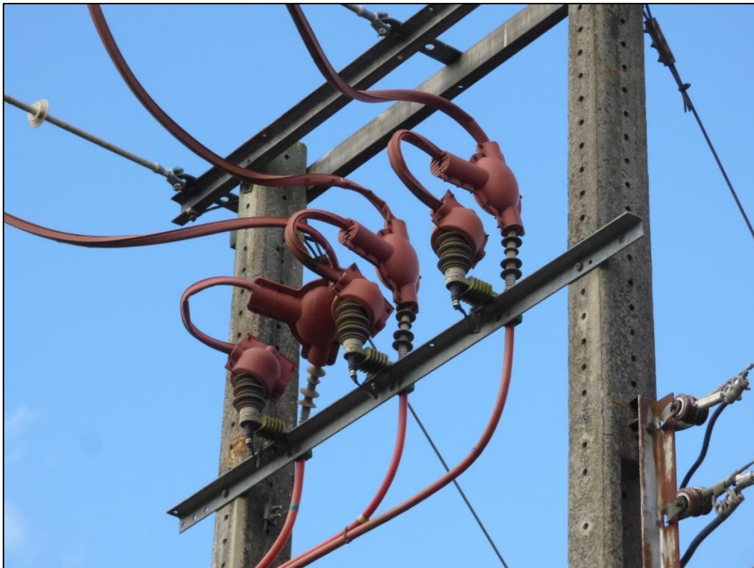
Figura 30. Detalle de las electroválvulas y sus terminales protegidas con preformados anti-electrocución en el apoyo de fin de línea y conversión aéreo/subterráneo nº 1079 de la Der. a Otaza.
