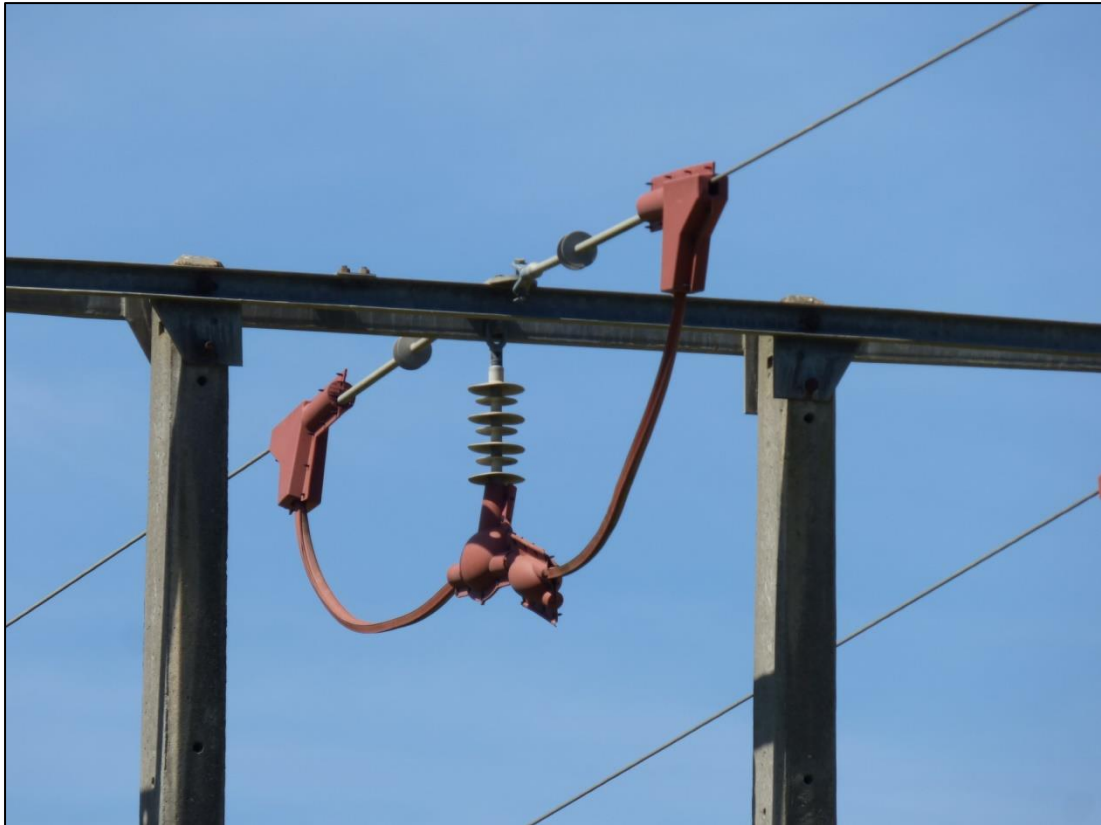
Figura 42. Apoyo de amarre en pórtico nº 1000 de la línea (13.2 kV) de Ali-Mendiguren en el que se aprecian las cadenas de amarre de 1.0 m, desprovistas de aletas, y las grapas de amarre y suspensión y los conectores protegidos con preformados específicos.
