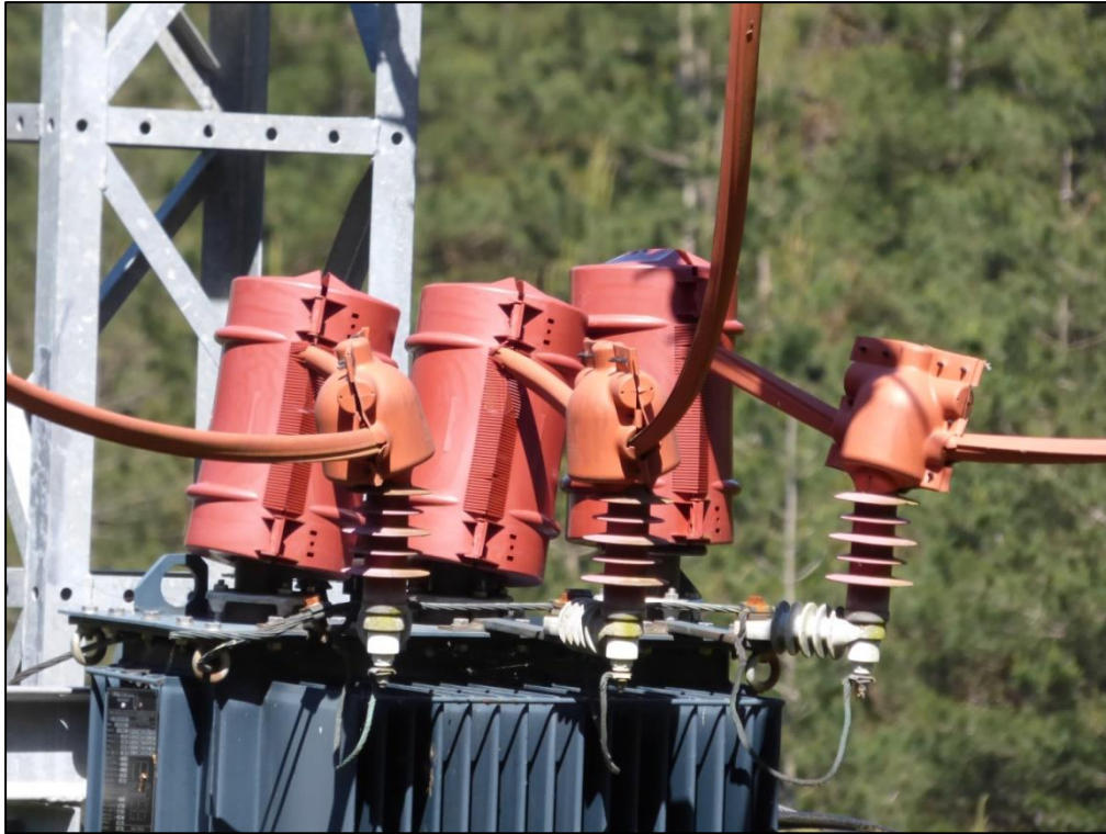
Figura 50. Detalle de los capuchones anti-electrocución utilizados en las autoválvulas y el transformador de intemperie de un apoyo de fin de línea.
