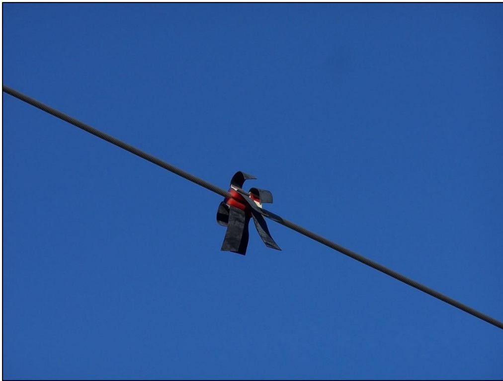
Figura 53. Detalle de las balizas salvapájaros ("X" de neopreno) desplazadas en el conductor por efecto del viento y la gravedad.
