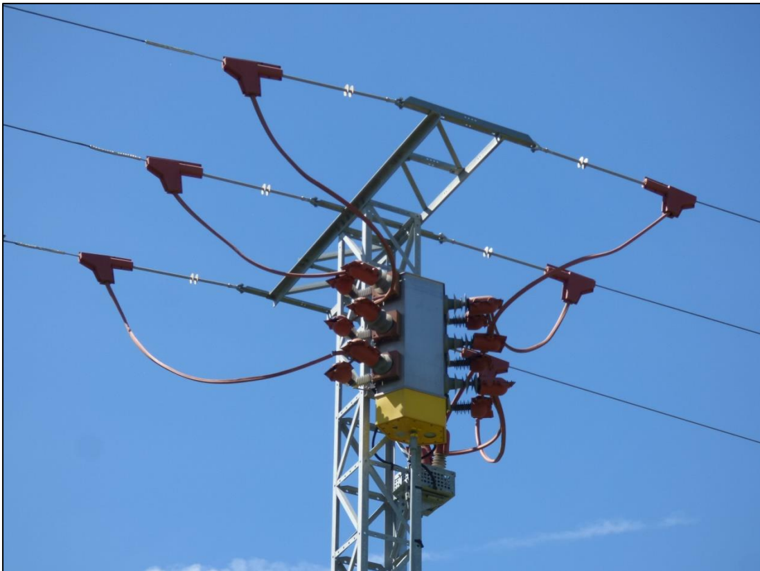
Figura 41. Apoyo de maniobra nº 15 (Vi-30121) de la Línea Ali-Goca mostrando los puentes aislados con cubiertas de silicona y las botellas y bornes del OCR protegidas con preformados específicos.
