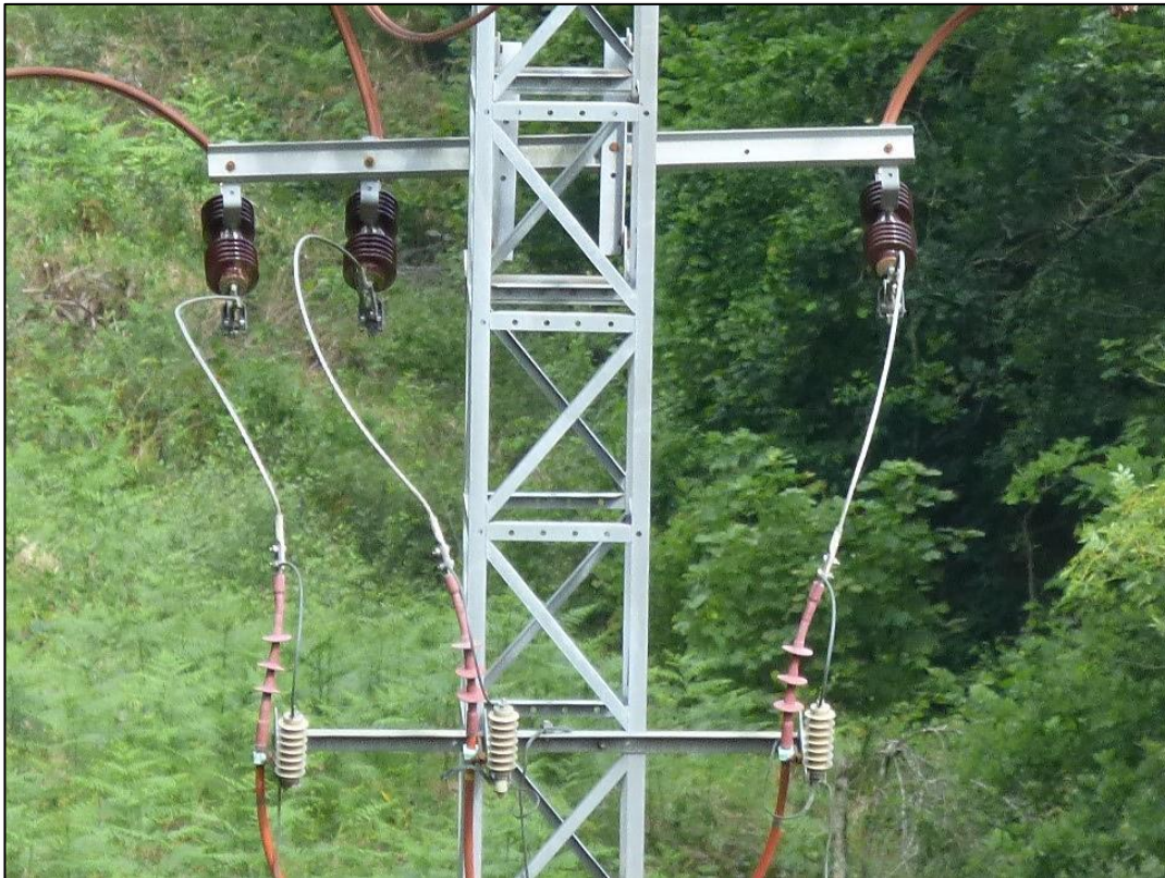
Figura 24. En la torreta de maniobra y conversión aéreo/subterránea nº 132 (SS-10908) se mantienen los fusibles-seccionadores y las válvulas sin proteger. Nótese que tampoco se han aislado los puentes desde los seccionadores hasta las electroválvulas.
