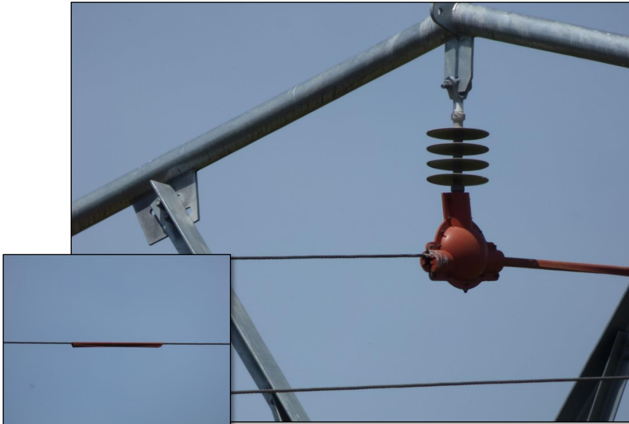
Figura 8. En algunos apoyos de alineación en bóveda las cubiertas de silicona de las fases centrales se han desplazado en el conductor perdiendo toda su eficacia (v.g.: Apoyos nº 9004 y 9005 de la Línea 13.2 kV de Carranza-Arcentaes CTO-3).
