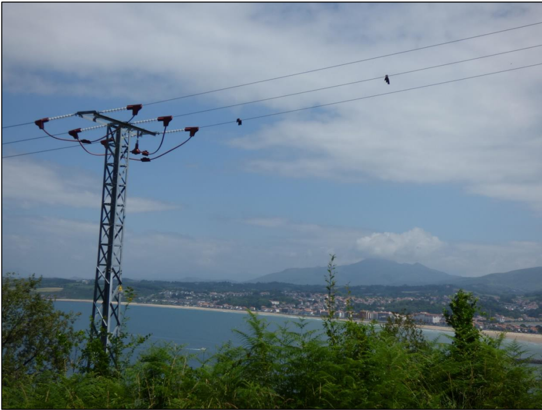
Figura 20. Tramo señalizado en la Der. al Cabo de Higer dentro de la línea (13.2 kV) de Txomorronea-Colonia Escolar. La señalización ha sido realizada mediante balizas salvapájaros ("X" de neopreno) instaladas alternativamente en las tres fases, utilizando cadencias de 1 baliza cada 20 m en cada hilo.
