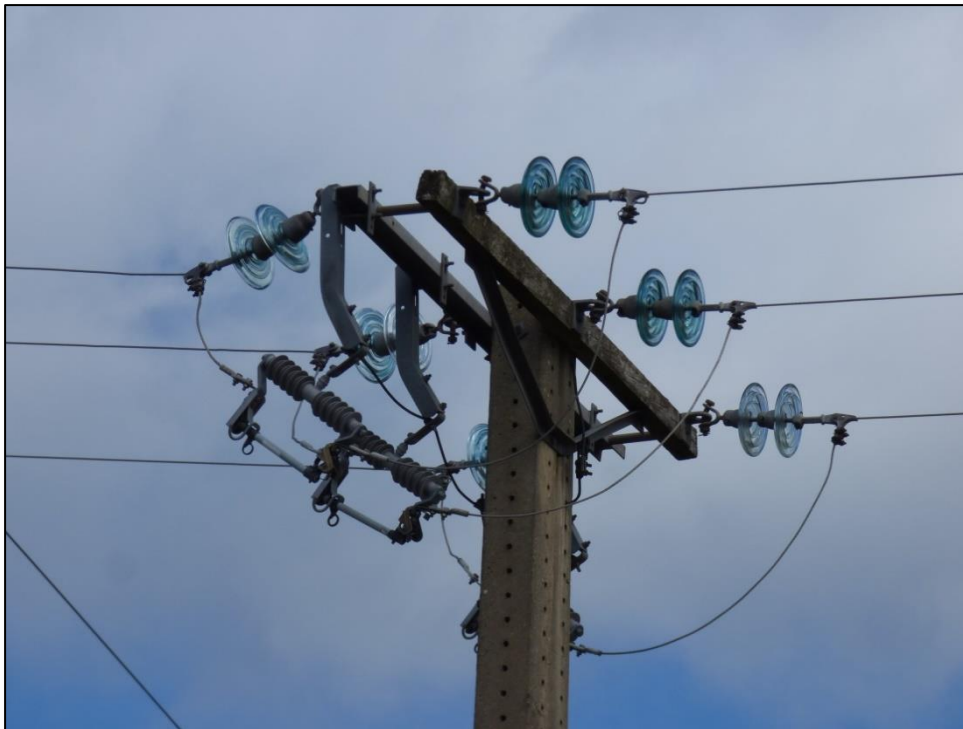
Figura 27. Apoyo de maniobra nº 1121 (Vi-41134) que se mantiene sin corregir, situado junto al apoyo de entronque nº 1107 de la Der. a Maturana.
