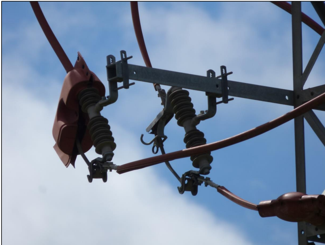
Figura 51. En los preformados cubre-seccionadores es preciso vigilar que los protectores queden bien fijados por los remaches para evitar que se desplacen o pierdan.
