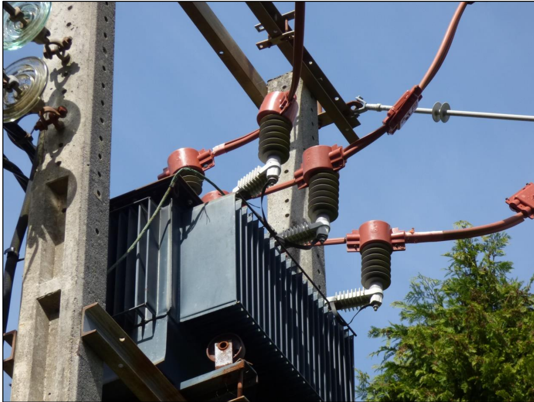
Figura 15. Detalle de los capuchones anti-electrocución utilizados para proteger las válvulas y los bornes del transformador de intemperie del apoyo de fin de línea nº 7612 (CT-333) de la Der. al Repetidor de Garbea (Sopuerta, Bizkaia).
