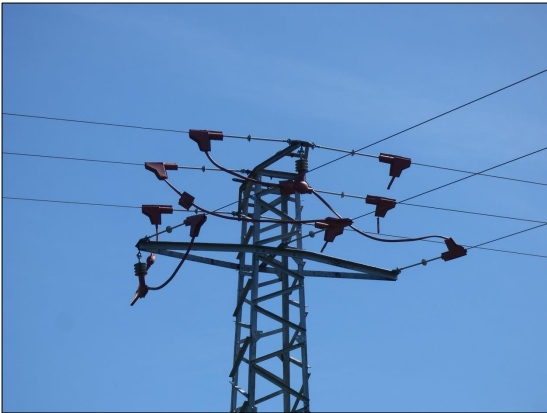
Figura 43. Apoyo de entronque n°15 en la Der. a Mendiguren en el que se aprecian las tres fases de la antigua derivación cortada.
