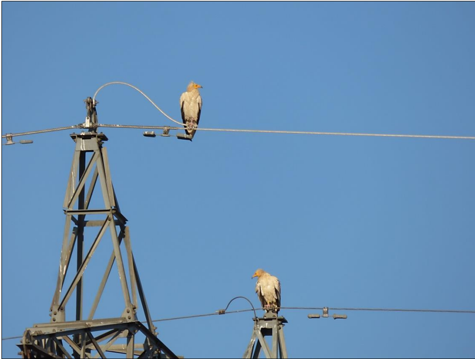
Figura 2. Las grandes rapaces, como el Alimoche, utilizan los apoyos de las LAAT no solo como oteaderos sino también como dormideros y como enclaves de protección, lo que incrementa el riesgo de sufrir accidentes por electrocución.
