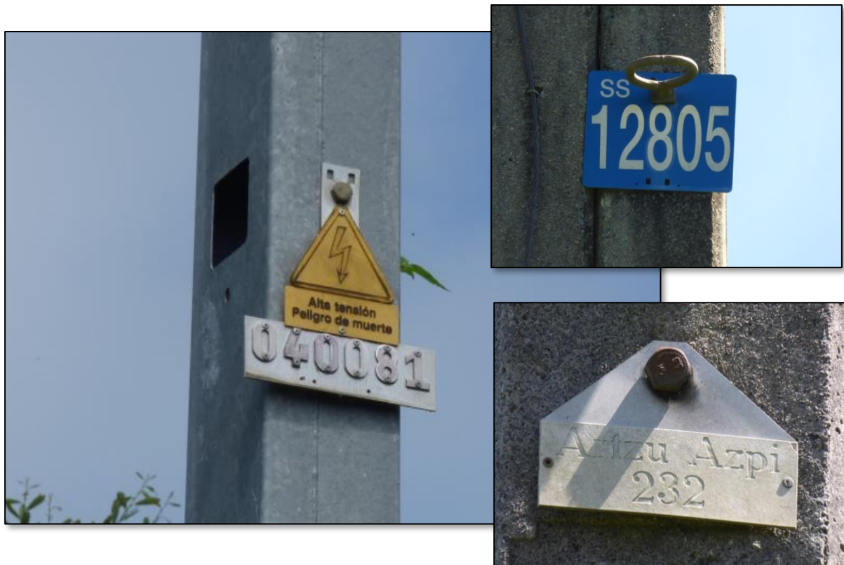
Figura 6. Detalle de la rotulación empleada por Iberdrola (I-DE) en el campo. Izquierda: nº del apoyo. Arriba: nº de maniobra. Abajo: número y nombre del centro de transformación de intemperie.
