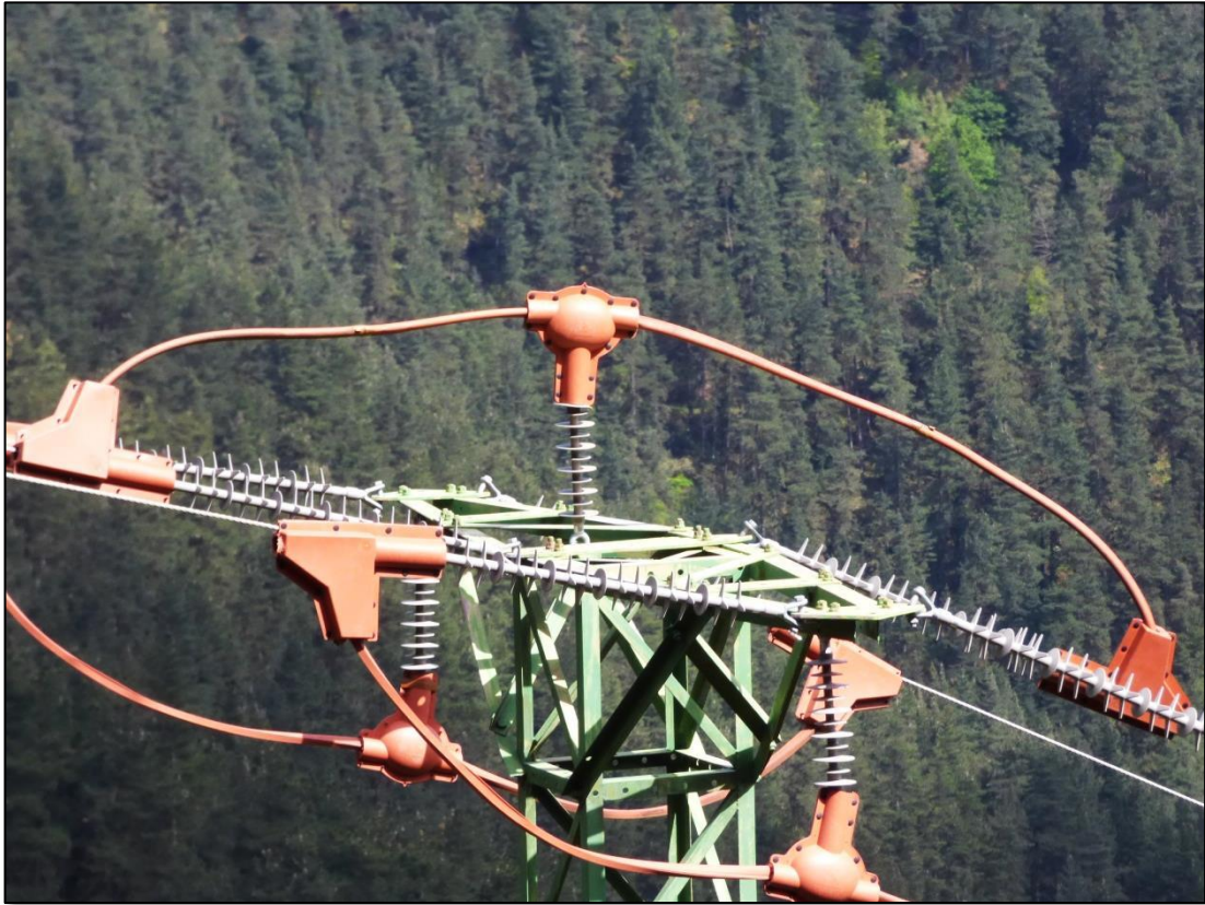
Figura 17. Detalle del puente flojo central aislado que se mantiene por encima del travesaño en la torreta nº 5619 de la Der. al repetidor de Untzeta. Dado que los materiales aislantes son perecederos hubiera sido conveniente reinstalar el puente flojo central suspendido por debajo del travesaño
