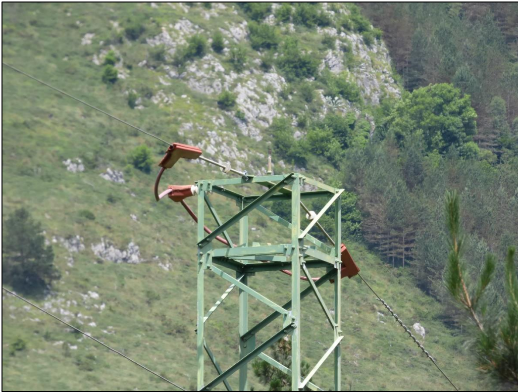
Figura 47. Detalle del sistema ARPI utilizado para soportar el puente flojo central en algunas torretas de amarre con montaje en triángulo.
