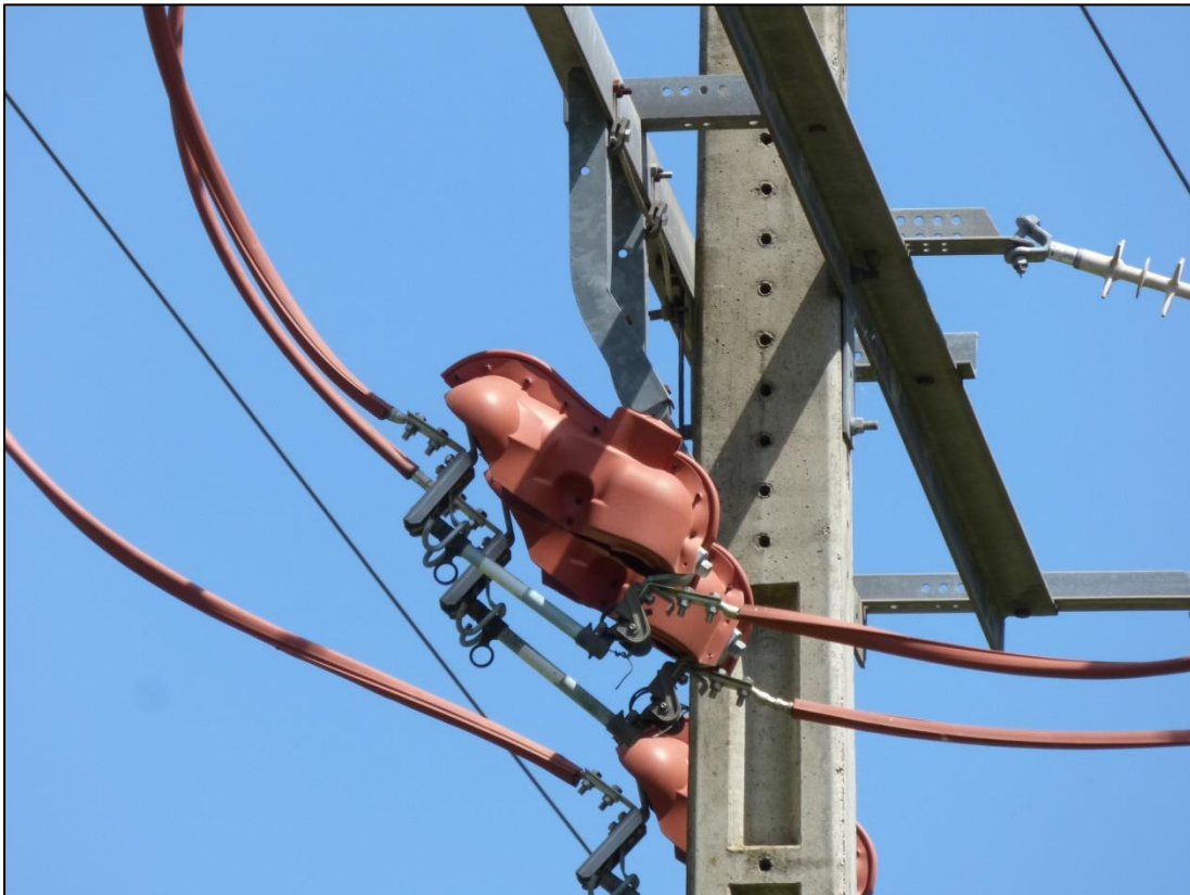
Figura 33. Detalle de los preformados que protegen los fusibles-seccionadores del apoyo nº 5474 (Vi-41671). Las entradas y salidas de los XS no han sido convenientemente aisladas reduciendo la eficacia de la medida.
