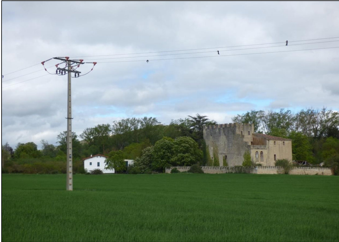
Figura 39. Der. al Caserío de Lacorzana mostrando el efecto de las balizas salvapájaros instaladas alternativamente en los 3 conductores con una cadencia de 1 baliza cada 20 m.
