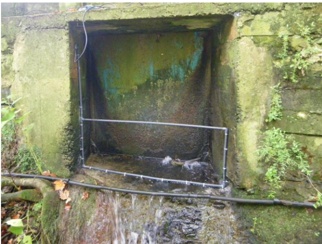
Foto 9. Antena 4 de detección, bypass cerrado
