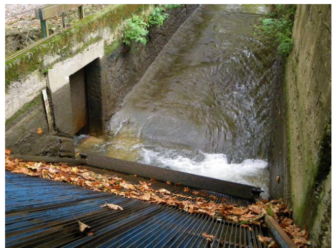
Foto 12. Rejilla y aliviadero-bypass al final del canal
