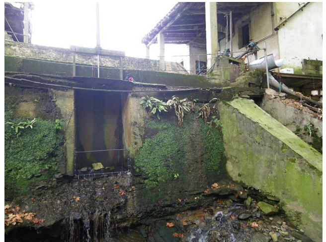
Foto 14. Antena 6 de detección, bypass-aliviadero cerrado
