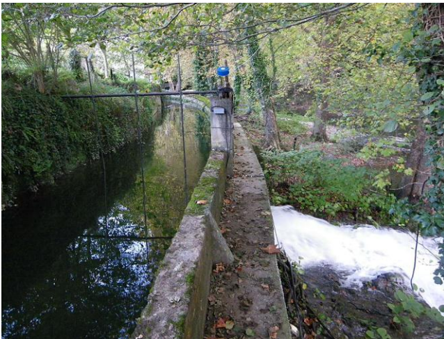
Foto 7. Barrera sónica y bypass expulsando agua
