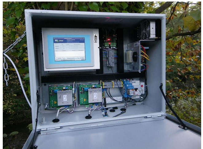
Foto 16. CPU del sistema de detección (CIPAM)
